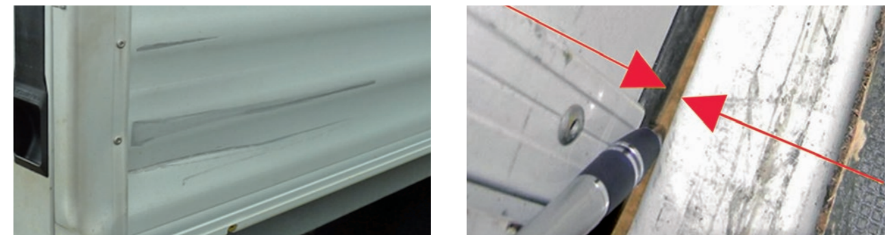
Odkształcenia szyn, których naprawa jest nieopłacalna, zamknięcie niemożliwe lub nie jest piaskoodporne
