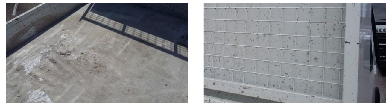
Ślady betonu lub produktu chemicznego zajmujące \geq 1/4 powierzchni zbiornika
