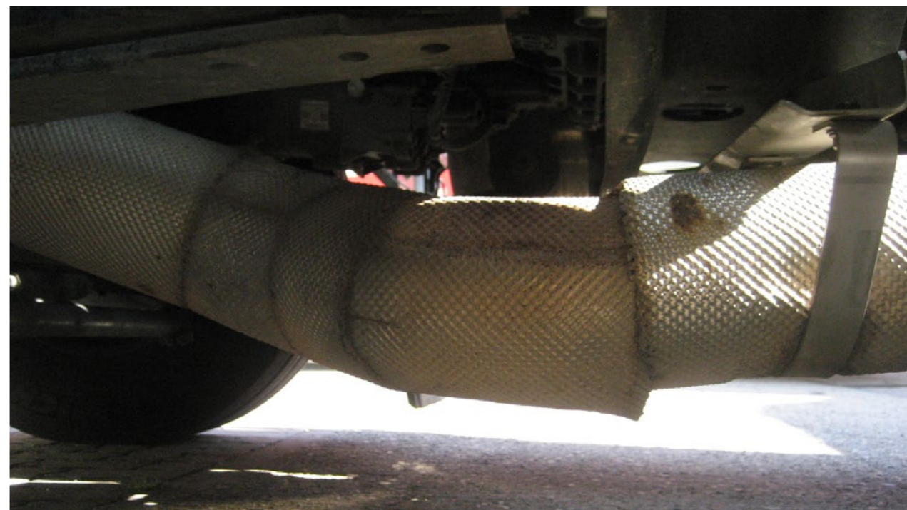
Niedopuszczalne są: pęknięte rury, rozerwana izolacja termiczna, głębokie rysy w materiale, wgniecenia zmniejszające średnicę rury.
