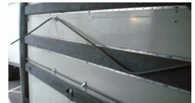
↻ Polsterung und Stangen: Stangen, Befestigungen, Polster fehlen oder sind verformt, können nicht auf wirtschaftliche Weise repariert werden
